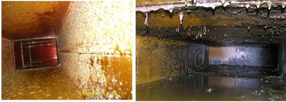
Рисунок 1 – Налипання жирів на стінках витяжних шахт після тривалого часу їх експлуатації
