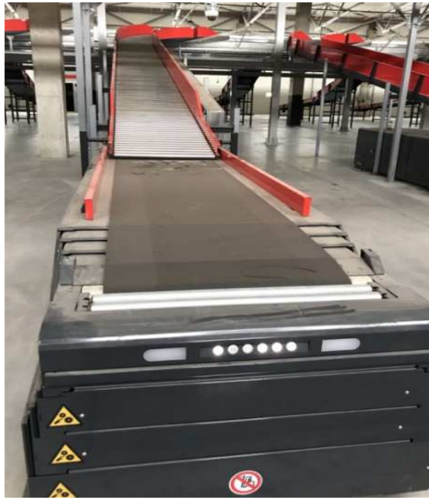
Рисунок – 4.6 Допоміжний боковий розподільний конвеєр логістичного складу ТзОВ "Нова пошта" Пустомитівського району Львівської області (Україна) [82]
