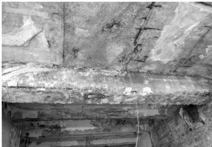
Рисунок 1.4 – Вигляд залізобетонної балки після нагрівання під час пожежі.
