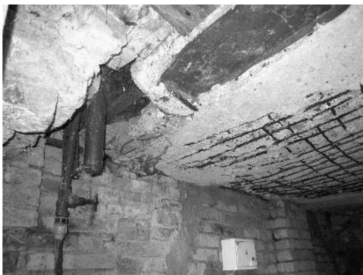
Рисунок 1.3 – Вигляд залізобетонної плити після пожежі
