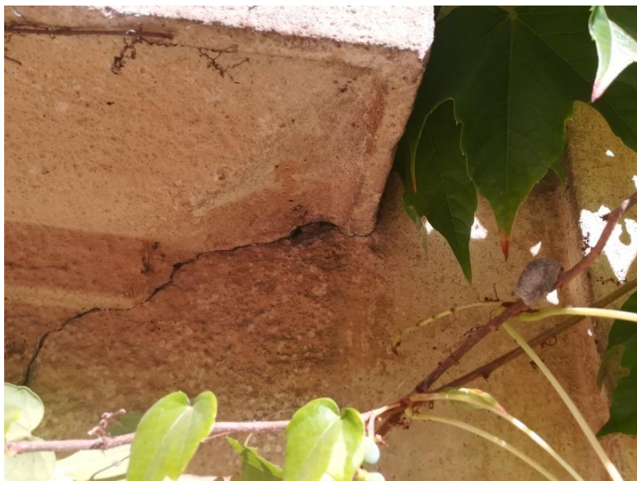
Рис. 6.9. Відірваний фрагмент штукатурки
