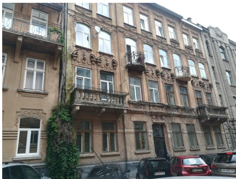
Рис. 6.10. Деформація водостічної труби через неправильну посадку P. quinquefolia (вул. Мартовича)
