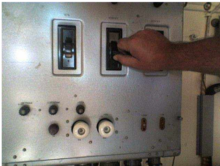
Рис.3.24 (а). Вимкнення автомату «АГРЕГАТ 1» на блоці № 44
