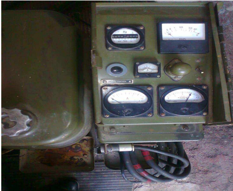
Рис. 3.16 (б) Контроль параметрів агрегату живлення
