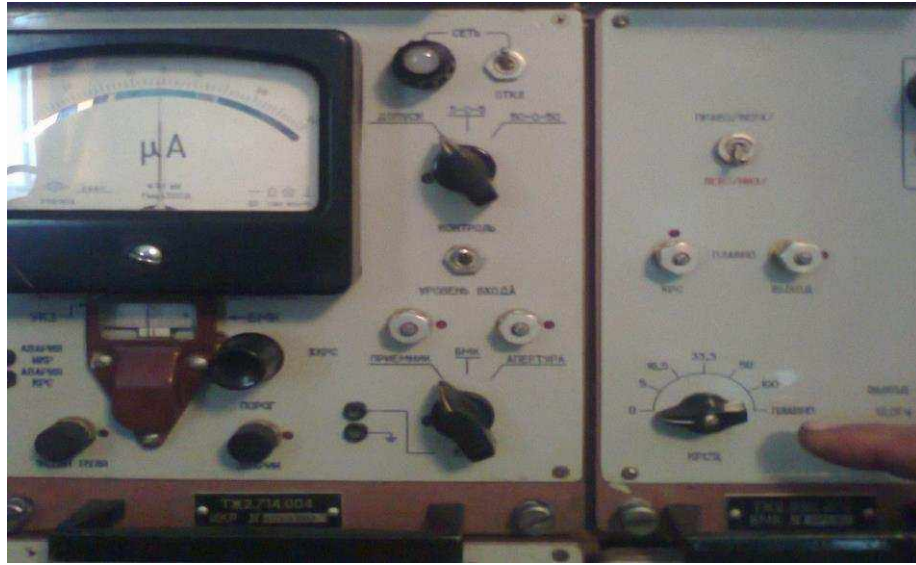
Рис. 3.19 (в). Проверка контрольной аппаратуры ДКРМ (ГРМ) по низкой частоте
