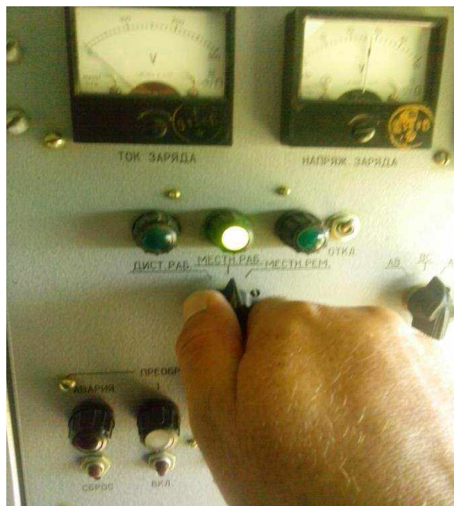
Рис. 3.20 (в). Щит живлення
