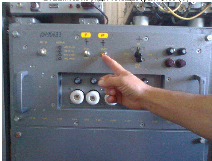
Рис. 3.11 (б). Вмикання радіостанції на стійці живлення та управління
