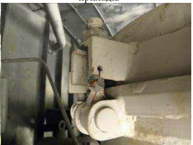
Рис.1.2 (г). Перевірка пломбування вузлів і агрегатів установки
