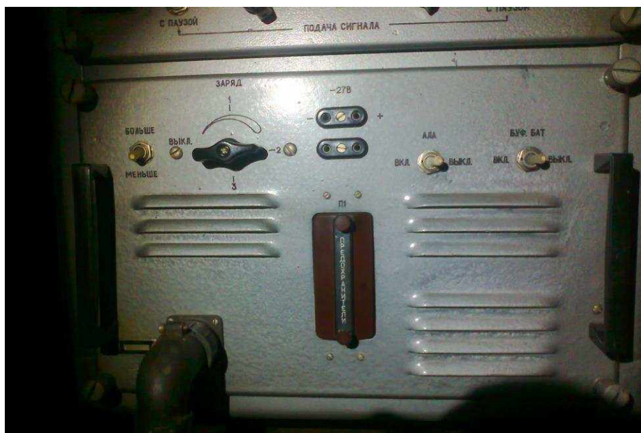
Рис. 3.17 (в). Вмикання радіостанції на силовому блоці
