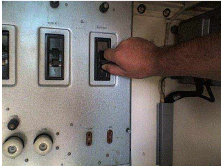
Рис.3.25 (б). Ввімкнення автомату «АГРЕГАТ 2» на блоці № 44
