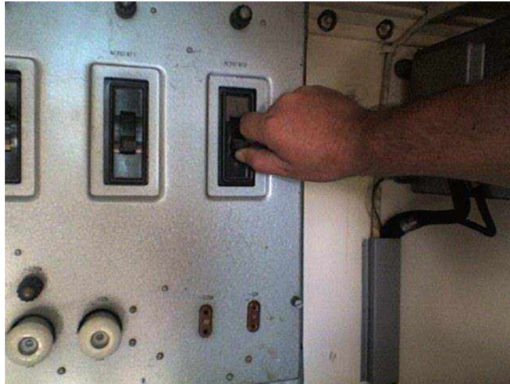
Рис.3.26 (б). Ввімкнення автомату «АГРЕГАТ 2» на блоці №44
