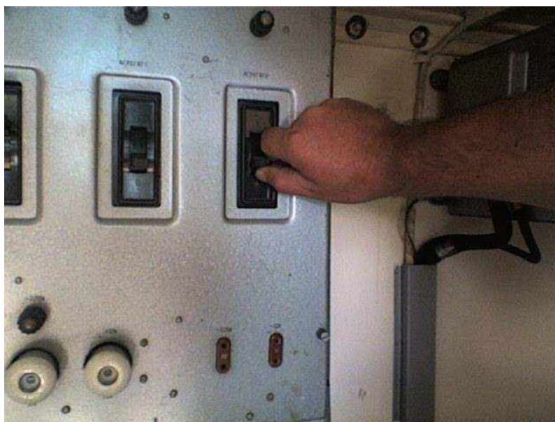
Рис.3.24 (а). Вимкнення автомату «АГРЕГАТ 2» на блоці № 44
