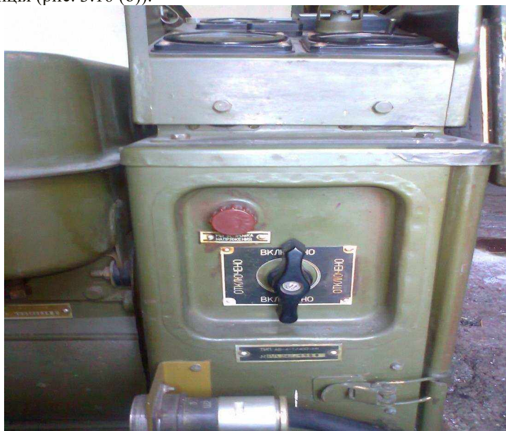
Рис. 3.16 (б). Запуск агрегату живлення
