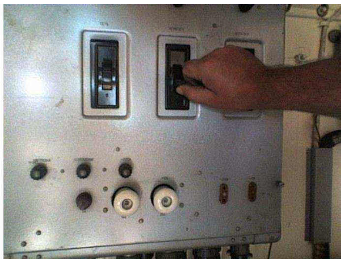
Рис.3.26 (б). Ввимкнення автомату «АГРЕГАТ 1» на блоці №44
