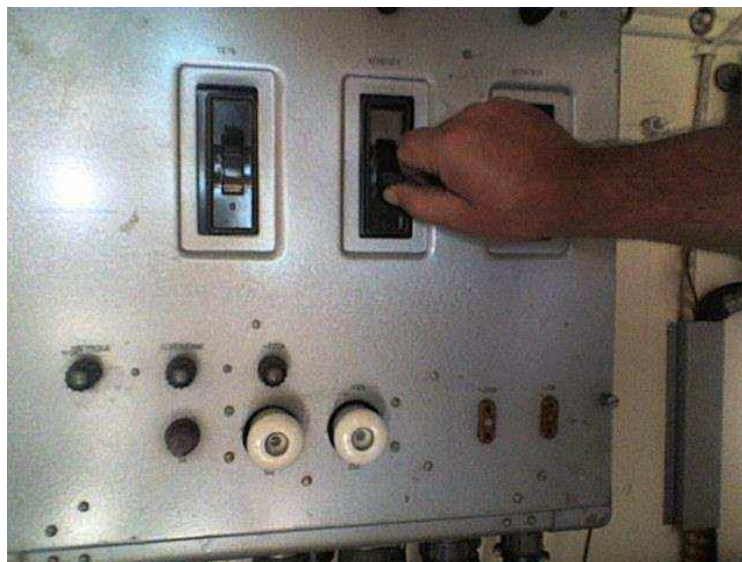
Рис.3.25 (б). Ввімкнення автомату «АГРЕГАТ 1» на блоці № 44
