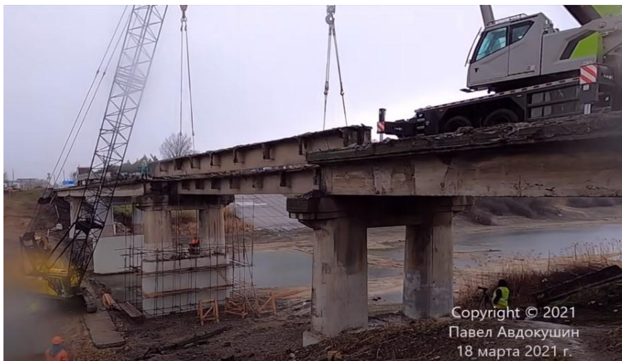
Рис.2 – Робочий момент демонтажу балки довжиною 33м важкою технікою (автор відео П. Авдокушин)
