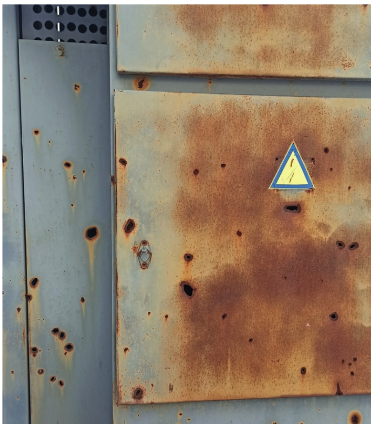
Рисунок 2.4 Наслідки обстрілу насосної станції «Гірська» (2017 р.) [26]
