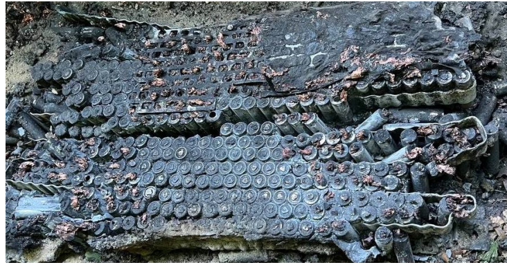
Рисунок 5.65– Зовнішній вигляд літій-іонного модуля батареї після проведення експерименту
