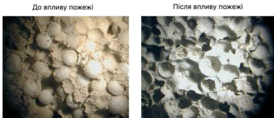
Рисунок 1.2 – Вигляд вогнезахисного штукатурного покриття до та після впливу пожежі
