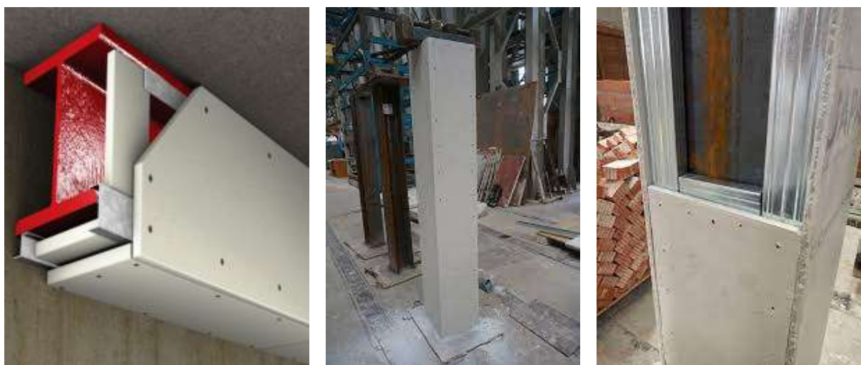
Рисунок 1.6 – Сталеві будівельні конструкції, захищені вогнезахисними плитами
