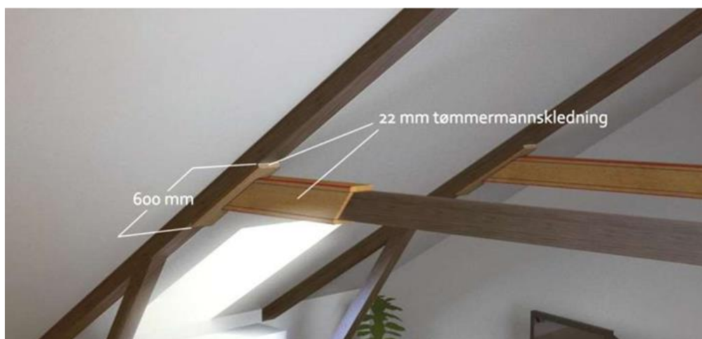
Рисунок 1.14 – Існуючі елементи конструкції покриті дошкою товщиною 22 мм.
