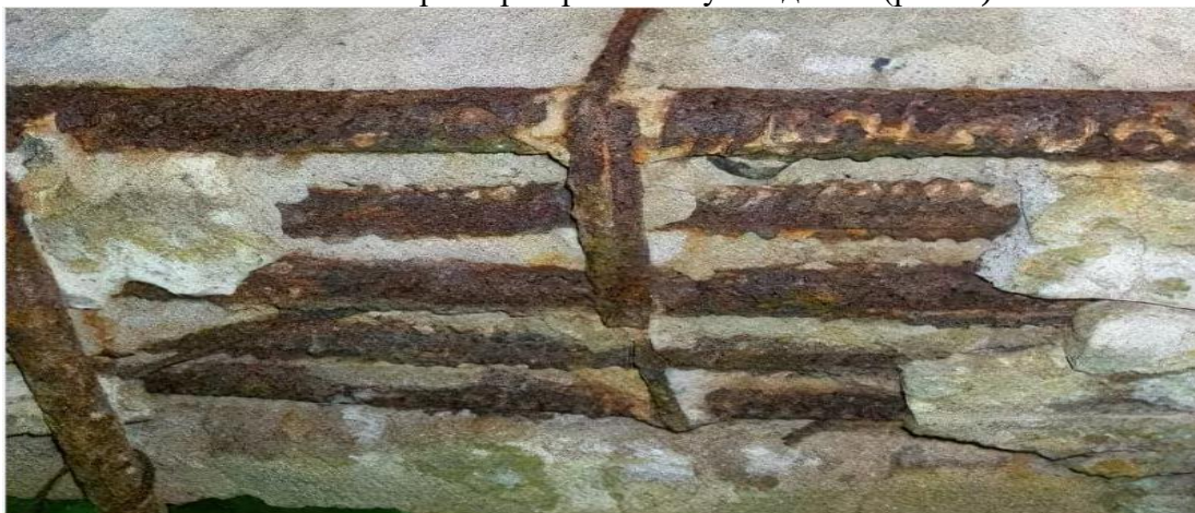
Рис. 1. Корозійні ушкодження арматури в залізобетоні
