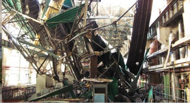
Наслідки руйнування покрівлі машинного залу після вибуху водню у корпусі турбогенератора на ТЕЦ-1
