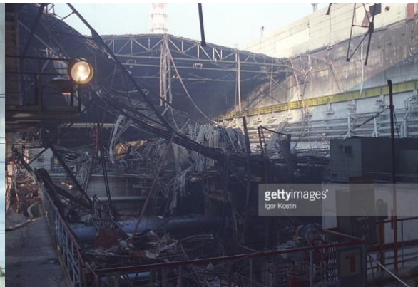
Наслідки пожежі після вибуху водню у турбогенераторі машинного залу № 2 Чорнобильської АЕС
