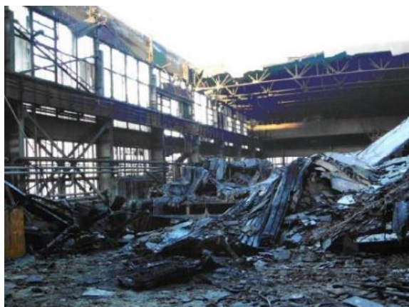
Рисунок 5 – Руйнування внаслідок вибуху воднево-оливної суміші в турбогенераторному залі ТЕС
