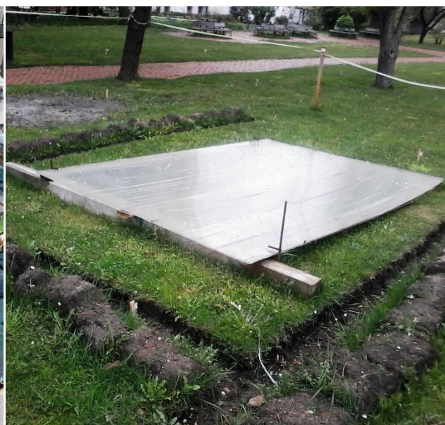
Рис. 2. Фотографія просідання ґрунту, який відбувся в 2015 р. (накритого та огороженого в цілях безпеки) в межах площадки на якій проводились роботи.
