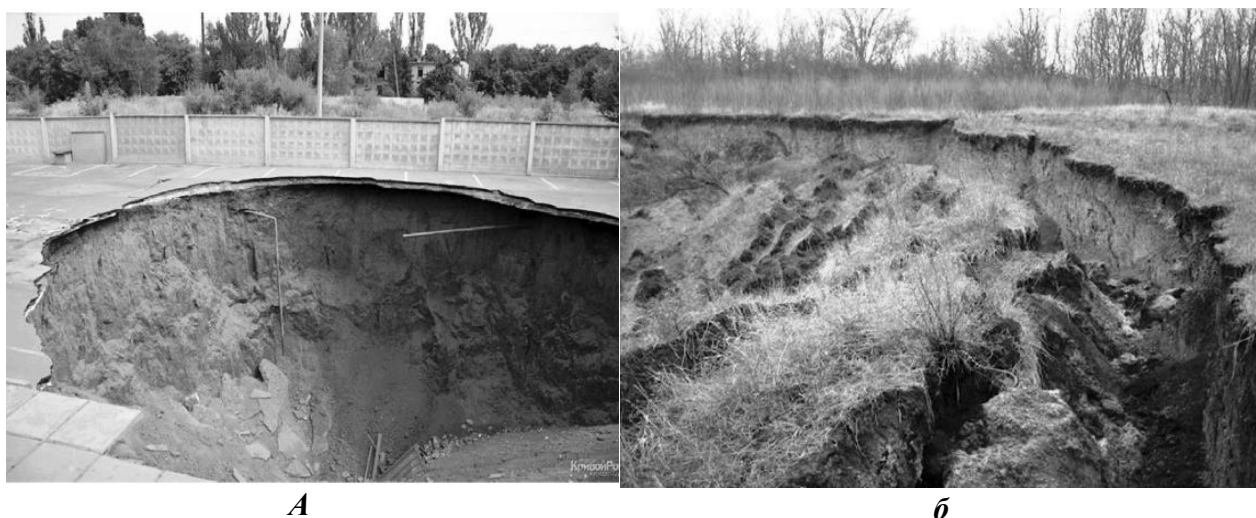
Рис. 4. Провал в центрі міста Кривий Ріг біля речового ринку (а) діаметром близько 15 м. та на його околиці (б) [1].
