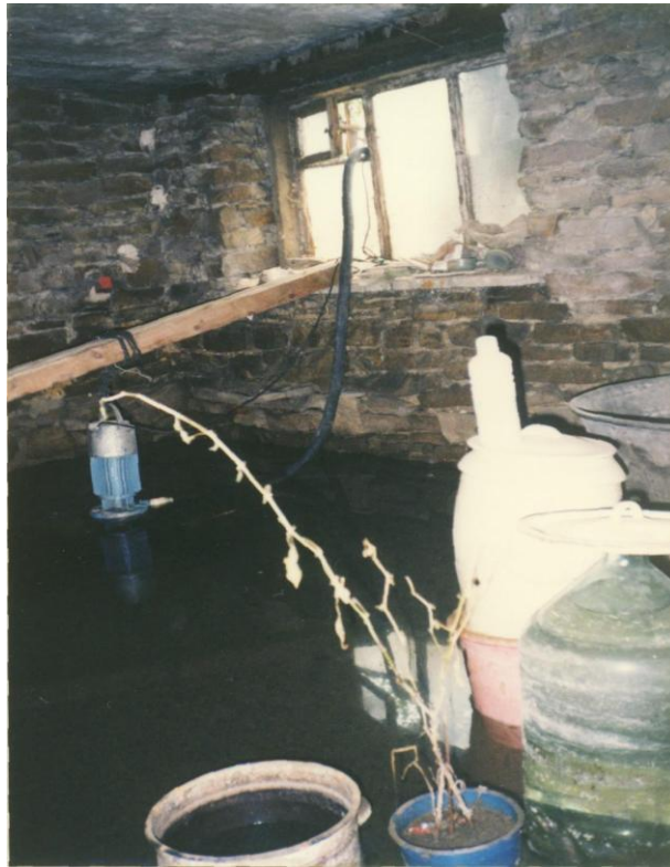
Рис. 3. Приклад затоплення підвалу житлового будинку (м. Краснодар) в зоні некеруємого підйому рівнів шахтних вод
