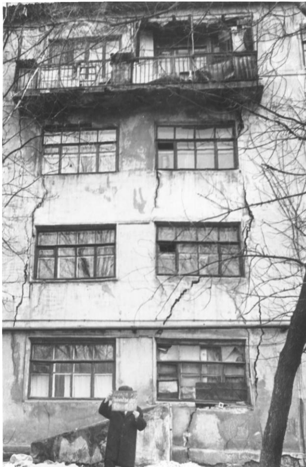
Рис. 4. Руйнівні деформації житлового будинку в зоні деформацій денної поверхні над виробками ш. "Кочегарка" (м. Горлівка).
