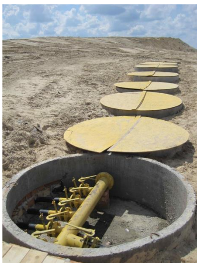
Рис.1. Ряд колекторів в бетонному колодязі
