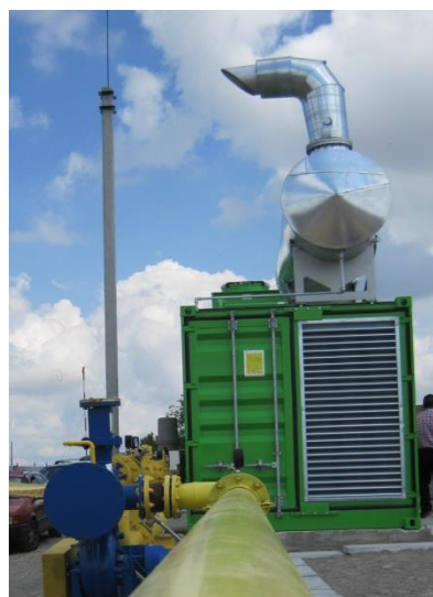
Рис.2. Зовнішній вигляд КГУ в контейнері
