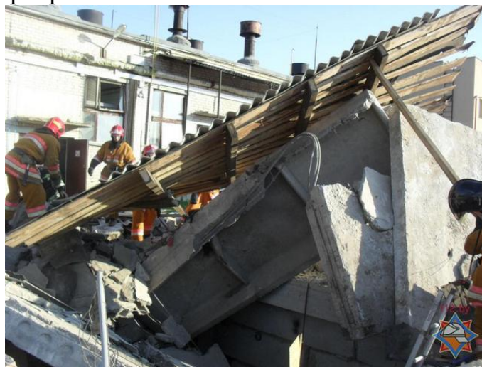
Рисунок 1. Разрушенные строительные конструкции
