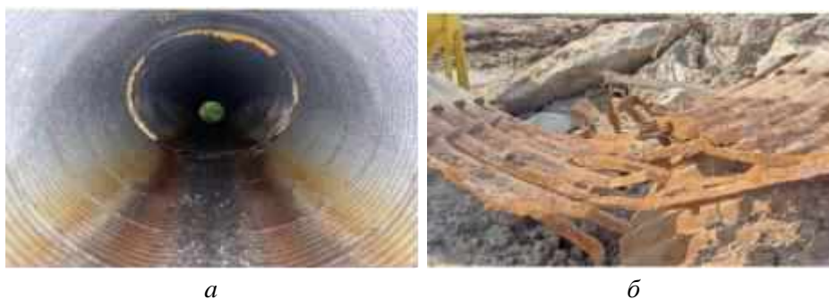
Рис. 2. Пошкодження МГК корозією в процесі експлуатації.
