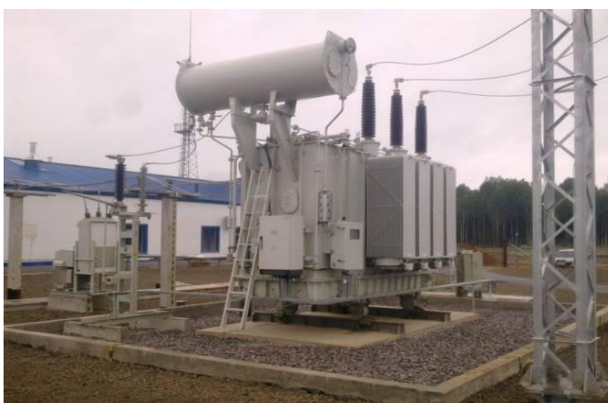
Рисунок 1.11 – Маслонаповнений трансформатор, встановлений у маслоприймач
