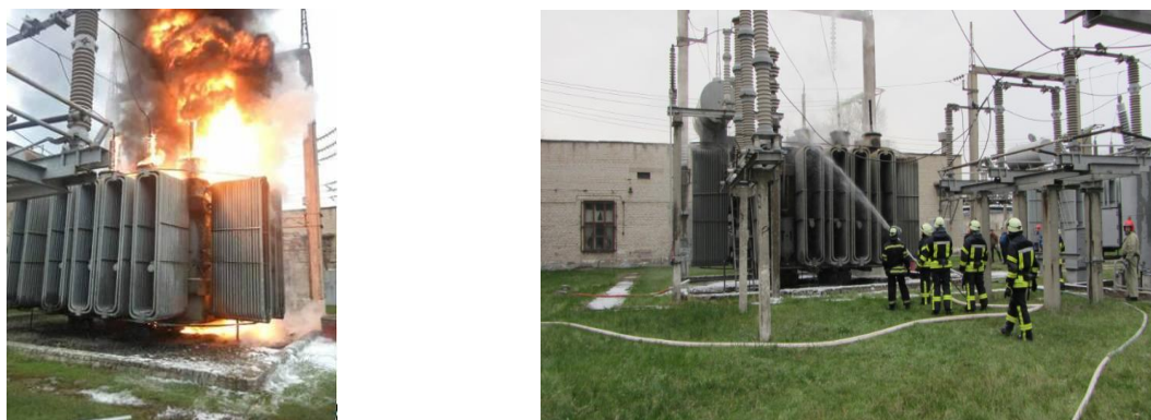
Рисунок 1.4 – Приклад пожежі на трансформаторній підстанції у м. Северодонецьк Луганської області
