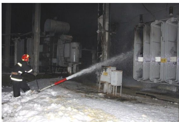
Рисунок 1.8 – Приклад пожежі на трансформаторній підстанції «Бортничі» у м. Києві
