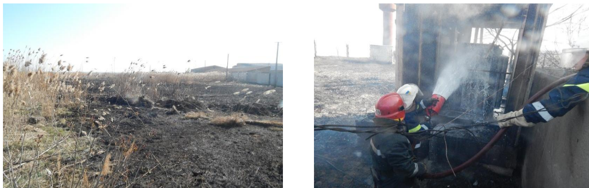
Рисунок 1.14 – Приклад загоряння трансформатору від пожежі сухої трави
