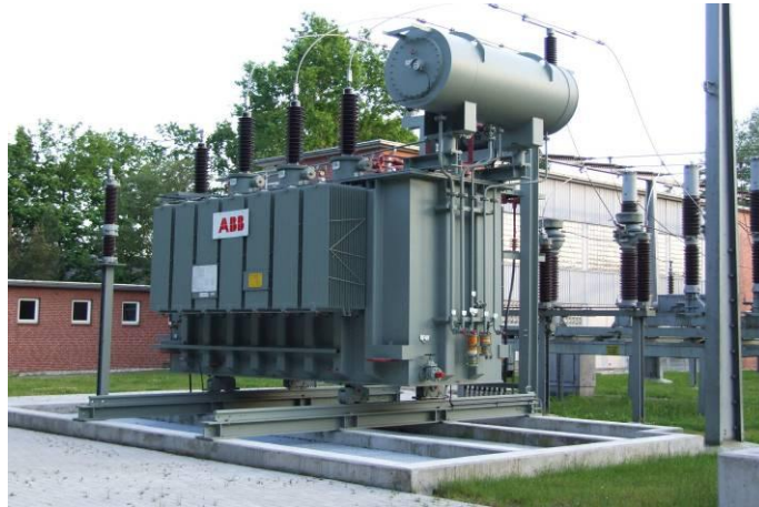
Рисунок 1.9 – Зовнішній вид трифазного силового трансформатора трансформаторної підстанції відкритого типу
