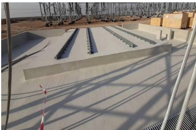
Рисунок 1.10 – Зовнішній вид площадки маслоприймача трансформаторної підстанції
