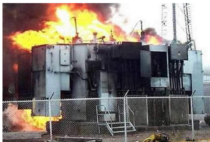
Рисунок 1.5 – Приклад пожежі на трансформаторній підстанції у смт Стара Ушиця Кам'янець-Подільського району Хмельницької області
