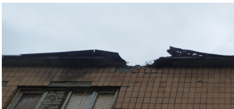
Рис. 8.9. Пошкодження крівлі навчально-спортивного комплексу
