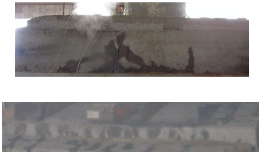
Рис. 4.15. Зовнішній вигляд тріщин, що виникли у досліджуваних сталезалізобетонних плитах під час випробувань.
