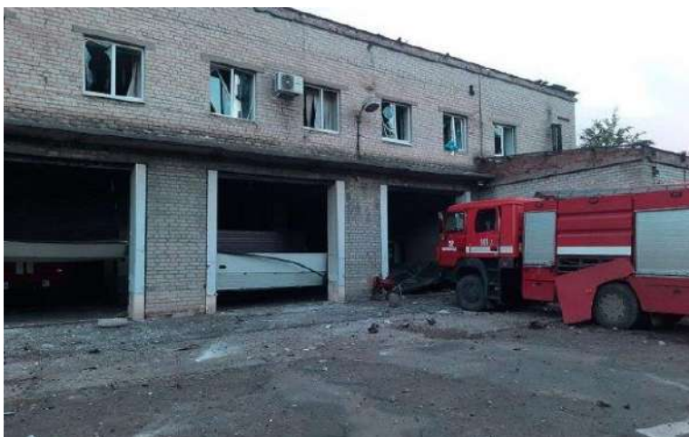
Рис. 4.1. Пошкоджена будівля пожежно-рятувальної частини у місті Костянтинівка Донецької області
