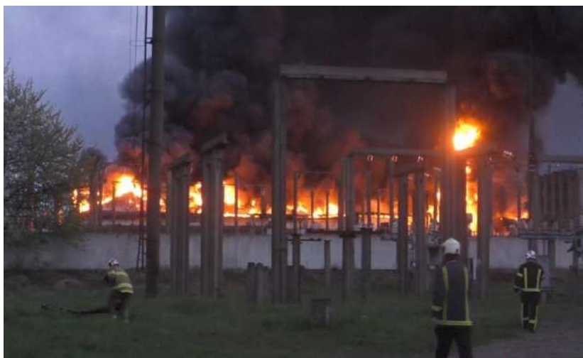
Рис. 1.27. Руйнування значної кількості технологічного обладнання об'єктів енергетики
