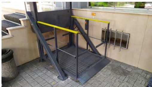
Рисунок 1 – Підйомний пристрій для МГН в будівлі, м. Київ
