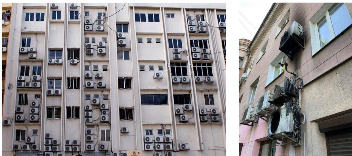
Рисунок 3.1 – Фото розміщення зовнішніх кондиціонерних блоків та наслідки пожежі
