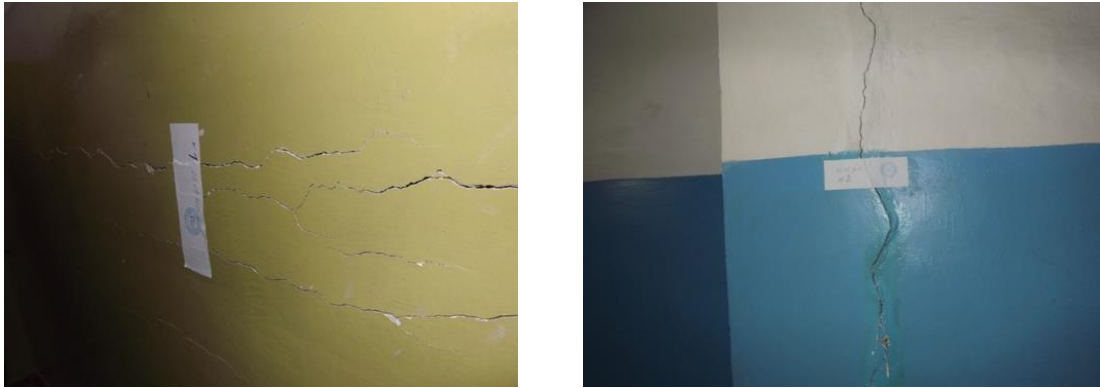
Рис. 2. Трещины в стенах школы п. Лисичанский (с. Малорязанцево)
