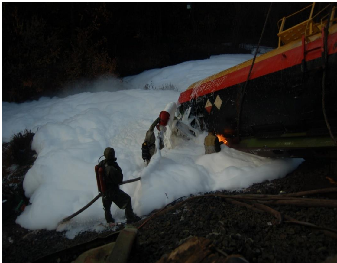
Рисунок 2 – Проведення електрозварювальних робіт ушкодженої залізничної цистерни з жовтим фосфором з використанням піни середньої кратності
