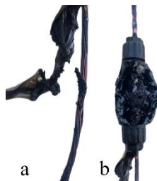
Рисунок 2 – Провідник(а) та з'єднання типу MS-4(б) після проведення випробування
