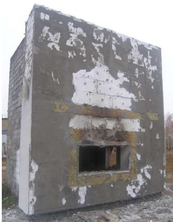
Рисунок 4.11 – Вид фрагмента зі знятим оздоблювально-захисним шаром фасадної теплоізоляції після проведення випробувань
