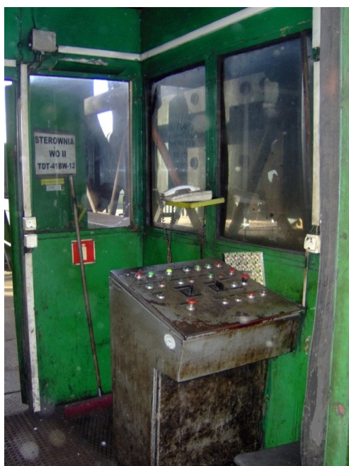
Rys. 2. Kabina sterownia wywrotnicy wagonowej, (opracowanie własne).
