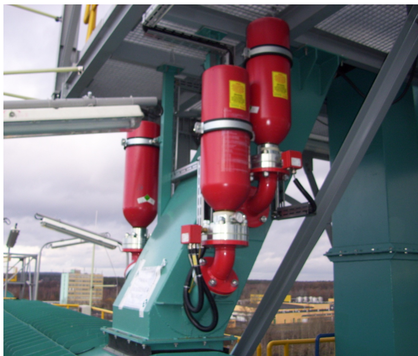
Fot. 1. Przykład zdecydowanego przewymiarowania w ilości technicznych systemów zabezpieczeń przeciwpożarowych i przeciwybuchowych na fragmencie rzeczywistej instalacji technologicznej.
