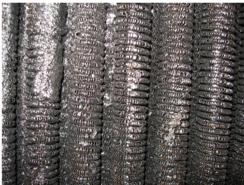
Рис. 1. Поверхность теплообмена со стороны входа воздуха в ОНВ
