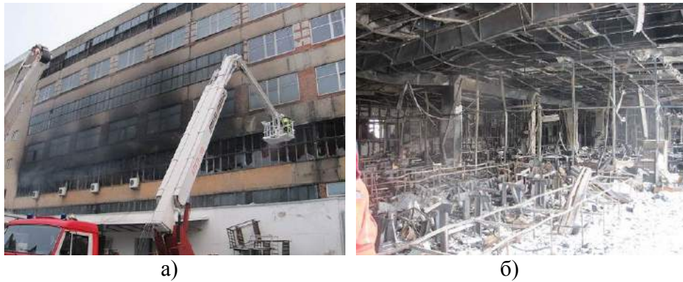
Рис. 1. Процесс ликвидации пожара (а) и последствия, вызванные пожаром производственных и складских помещений швейного предприятия (б)
