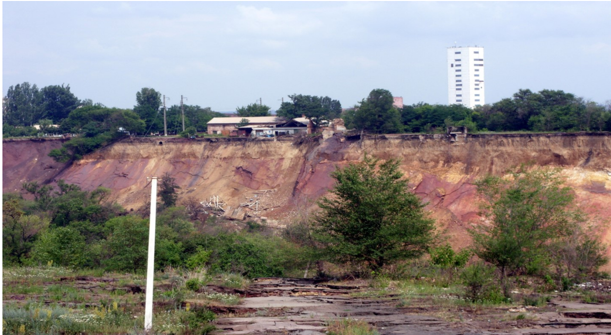
Рис. 1. Загальний вигляд провалу денної поверхні у Кривбасі на полі шахти ім. Ордженикідзе (16.06.2010, площа 160 тис. м 2 , глибина 40–45 м, об'єм до 7 млн м 3 , фото Малахова І.М.)
