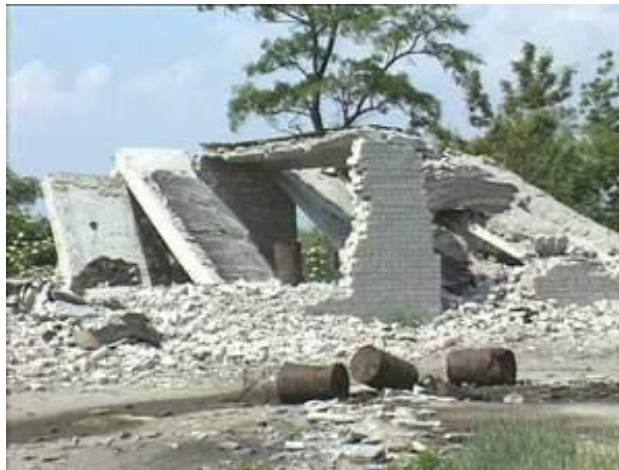
Рис. 7.9. Зруйнований часом склад для зберігання отрутохімікатів на території Дніпропетровської області
